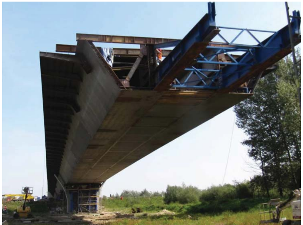
Rys. 17. Most w Kamieniu, L = 80,00 + 8 \times 108,00 + 80,00 m. Montaż wspornikowy przez nasunięcie podłużne (foto. K. Żółtowski)
