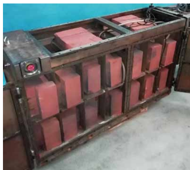
Rys. 7. Widok wypełnienia wnętrza komory skrzyni akumulatorowej [7]
