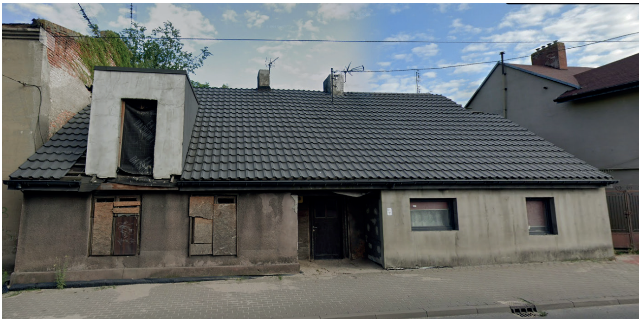
Rys. 3. Drewniany budynek z samowolnym ociepleniem, rozbudową i wymianą pokrycia dachowego, obecnie nieobjęty ochroną konserwatorską; źródło: fot. aut.
