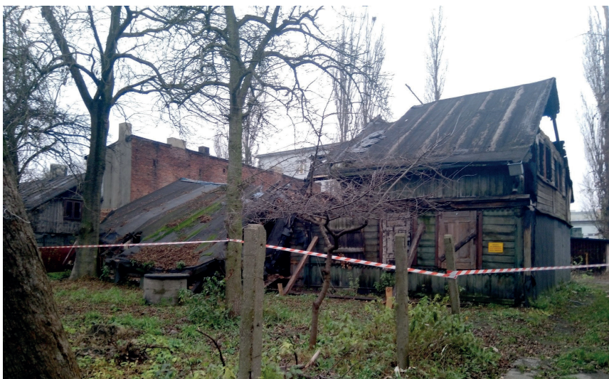
Rys. 5. Budynek drewniany ujęty w gminnej ewidencji zabytków, w którym oryginalna substancja została nieodwracalnie zniszczona w stopniu znacznym; źródło: fot. aut.
