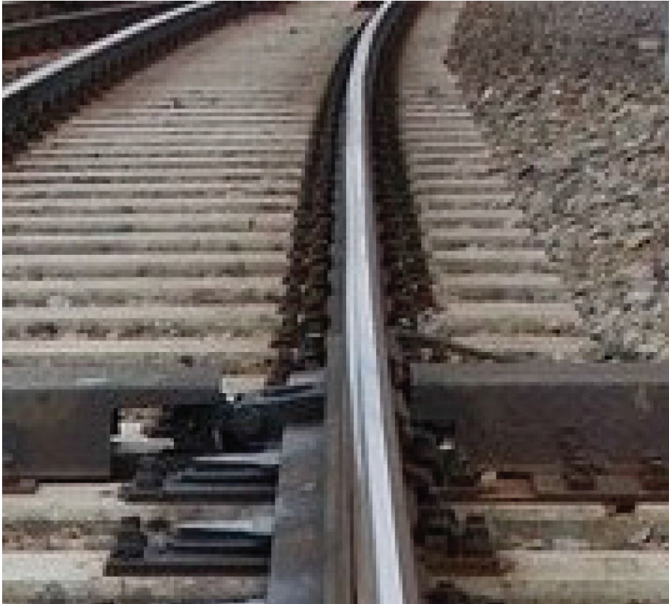
Fot. 1. Nieregularne połączenie wstawki pomiędzy rozjazdami 43 i 54 widoczne na fotografii
