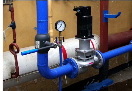
Rys. 9. Widok urządzenia modelowego po zamontowaniu w przewód sieciowy
