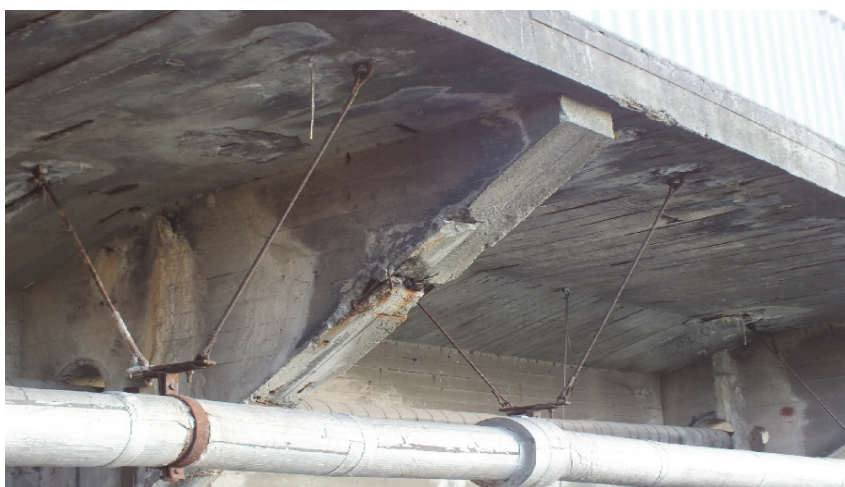
Rys. 23. Szczegóły uszkodzeń konstrukcji mostu w ciągu ul. Płochocińskiej nad kanałkiem do Faelbetu
