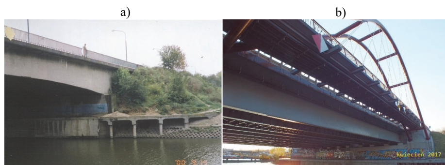
Rys. 14. Porównanie starych i nowych konstrukcji obiektów nad Kanałem Żerańskim; a) konstrukcja z 1957r. (stan z 2000r.); b) konstrukcja z 2011r. (stan z 2017r.) – na pierwszym planie konstrukcja kładki dla pieszych
