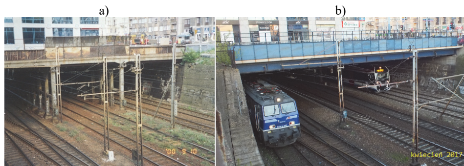
Rys. 2. Wiadukt w ciągu ul. Żelaznej nad torami PKP – porównanie konstrukcji; a) konstrukcja z 1926r. (stan z 2000r.); b) konstrukcja z 2005r. (stan z 2017r.)
