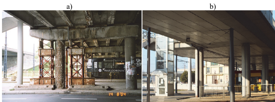
Rys. 18. Obiekty Trasy Toruńskiej nad ul. Modlińską – porównanie; a) konstrukcje z prefabrykowanych, strunobetonowych belek korytkowych (stan z 2004r.); b) nowe konstrukcje z belek prefabrykowanych, strunobetonowych typu Kujan NG (stan z 2017r.)
