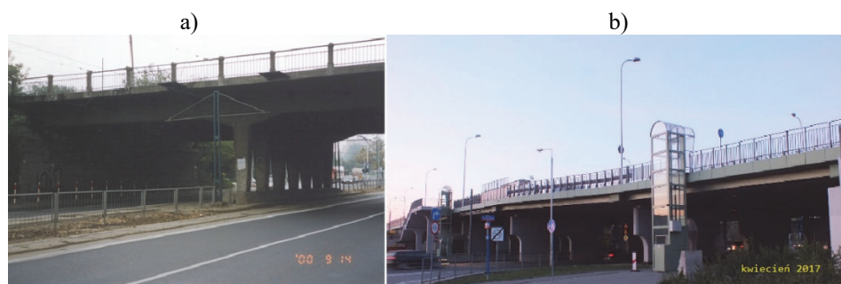
Rys. 7. Wiadukt drogowy nad ul. Z. Słomińskiego — porównanie konstrukcji; a) stara — żelbetowa (stan z 2000r.); b) nowa — zespolona z 2012r. (stan z 2017r.)
