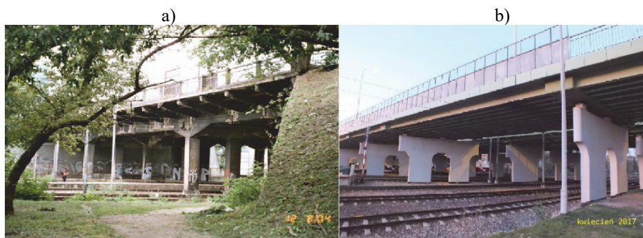
Rys. 6. Wiadukt kolejowy w ciągu ul. Mickiewicza – porównanie konstrukcji; a) stara – żelbetowa (stan z 2004r.); b) nowa – zespolona z 2012r. (stan z 2017r.)
