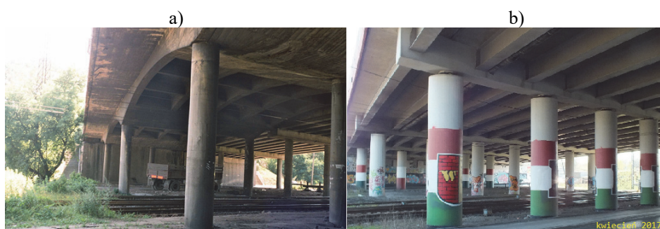
Rys. 3. Wiadukty w ciągu ul. Płowieckiej – porównanie konstrukcji; a) stara - konstrukcja żelbetowa (północna, stan z 2004r.); b) nowa – konstrukcja zespolona z 2006r. (stan z 2017r.)
