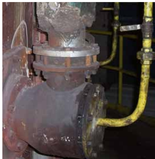
Rys. 1. Palnik wirowy w ścianie pieca z obrotowym trzonem o średnicy podziałowej 6,5 m
