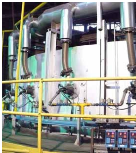
Rys. 2. System grzewczy pieca z obrotowym trzonem o średnicy podziałowej 6,5 m po modernizacji Fig.2. Heating system of carousel furnace: effective diameter after modernization 6,5m
