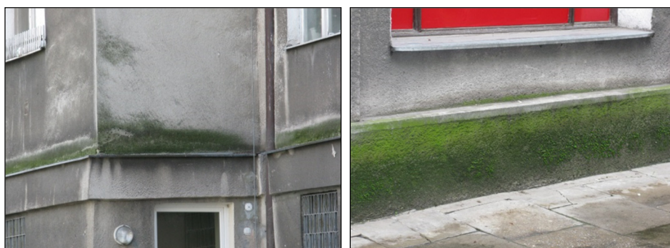
Rys. 2. Rozwój korozji biologicznej na ścianach budynków mieszkalnych w najstarszej części Nowej Huty w Krakowie (fot. T. Kusionowicz)
