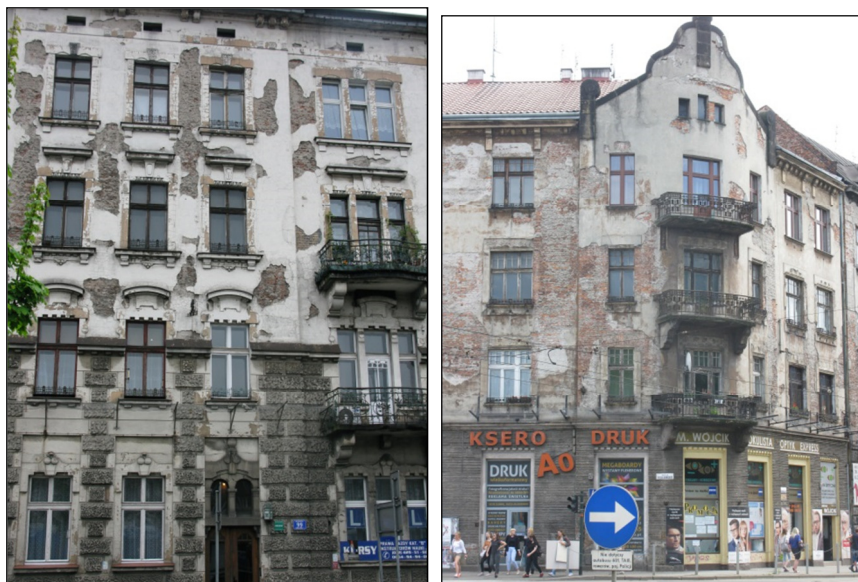
Rys. 1. Uszkodzenia tynków na elewacjach zabytkowych budynków w Krakowie (fot. T. Kusionowicz)
