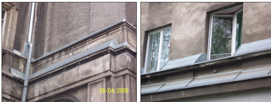
Rys. 3. Nowe obróbki blacharskie gzymsów na ścianach budynków mieszkalnych w najstarszej części Nowej Huty w Krakowie (fot. T. Kusionowicz)
