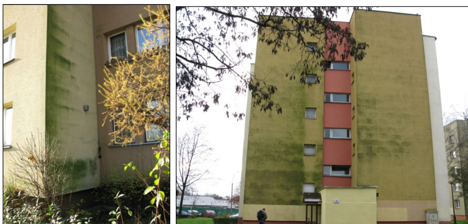
Rys. 4. Rozwój korozji biologicznej na docieplanych ścianach zewnętrznych budynków mieszkalnych w Nowej Hucie w Krakowie (fot. T. Kusionowicz)
