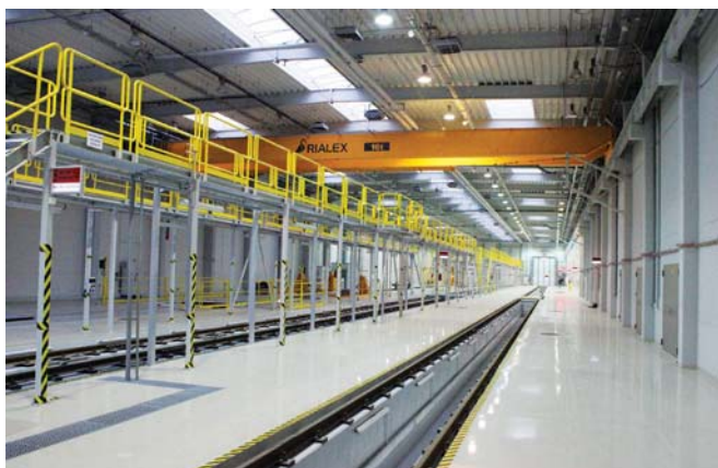
Hala przeglądowo-naprawcza. Fot. A. Massel
