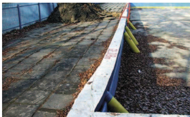
Rys. 5. Przykład uszkodzonej ścianki oporowej (zdjęcie S. Kwiecień)
