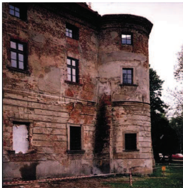
Rys. 1. Przykład uszkodzonego obiektu (zdjęcie autora)
