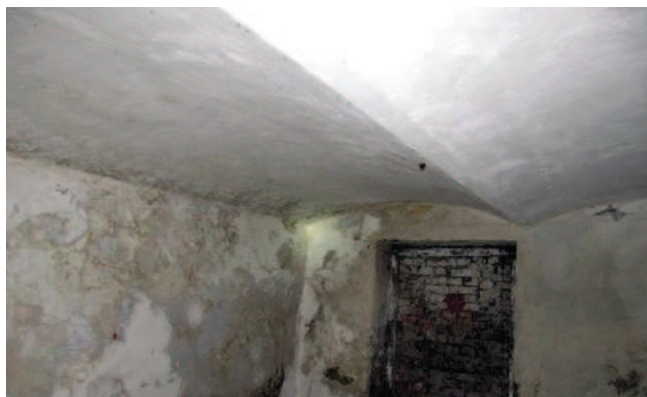
Rys. 2. Przykład zawilgoconej piwnicy (zdjęcie Z. Pająk)
