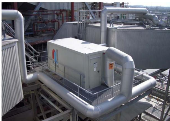
Rys. 5.1. Kontener z instalacją kondycjonowania spalin [14]
