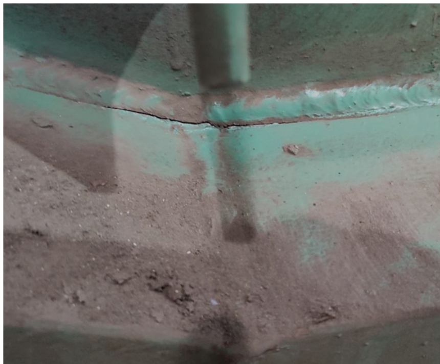
Fot. 8. Pęknięcie spoiny pachwinowej przy blasze węzłowej na środniku C200
