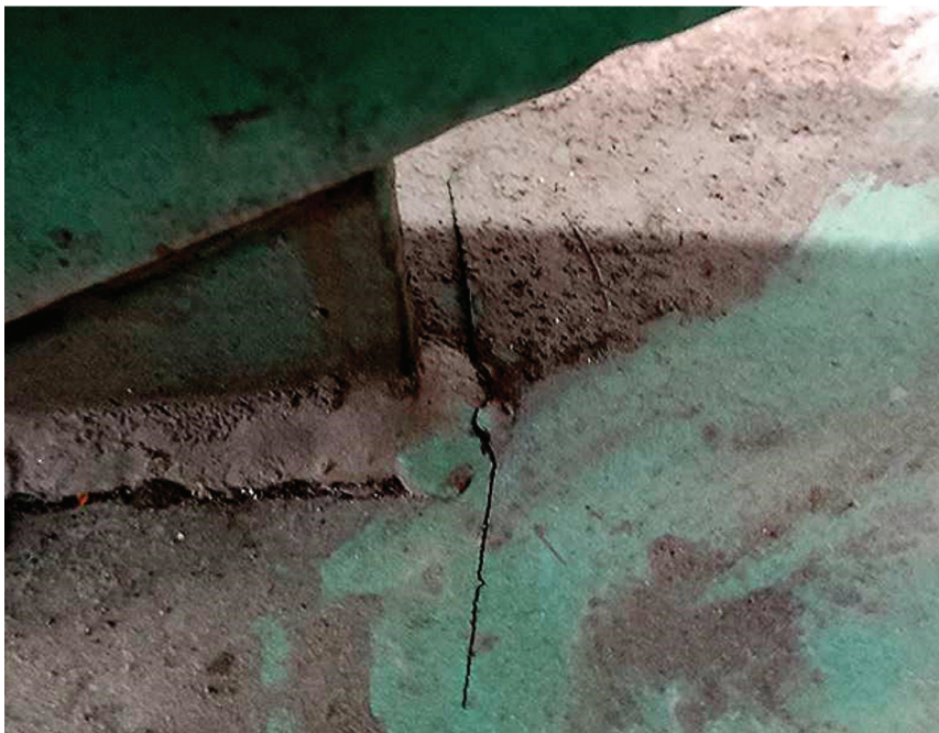
Fot. 6. Pęknięcie w materiale rodzimym w C200 w śródniku przy strefie wpływu ciepła
