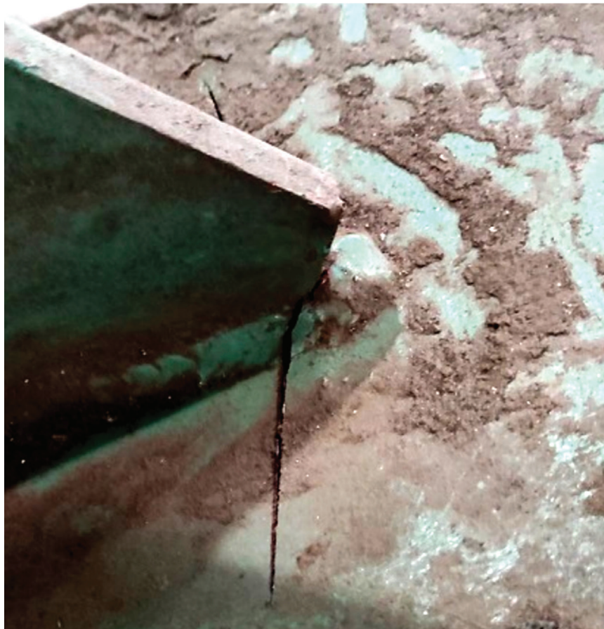
Fot. 7. Pęknięcie w materiale rodzimym w C200 przy strefie wpływu ciepła
