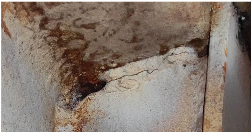
Fot. 5. Pęknięcie spoiny pachwinowej przez żebrze poprzecznym w półce górnej IPN500
