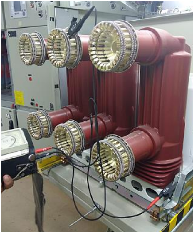
Rys. 2. Pomiar rezystancji izolacji głównej wyłącznika Sn pomiędzy fazą a ziemią [fot. opracowanie własne autorów artykułu]
