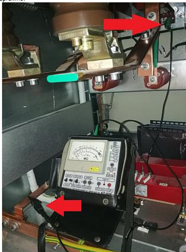
Rys. 6. Pomiar rezystancji izolacji uzwojenia wtórnego indukctorem Adex AD-1025 [fot. opracowanie własne autorów artykułu]
