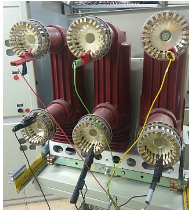
Rys. 3. Pomiar niejednoczesności otwierania i zamykania oraz czasów własnych wyłącznika [fot. opracowanie własne autorów artykułu]
