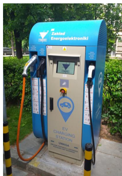
Rys. 10. Stacja ładowania wyposażona w moduł ładowarki EVC1000
