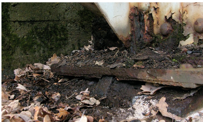
Fot. 7. Zniszczona blacha nadłożyskowa i półka dolna dźwigara na skutek korozji spowodowanej zaleganiem liści
