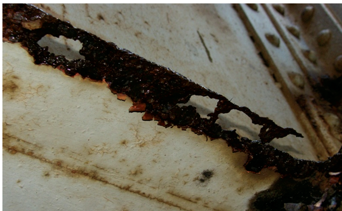
Fot. 6. Uszkodzenia korozyjne dolnej półki spowodowane zaleganiem liści
