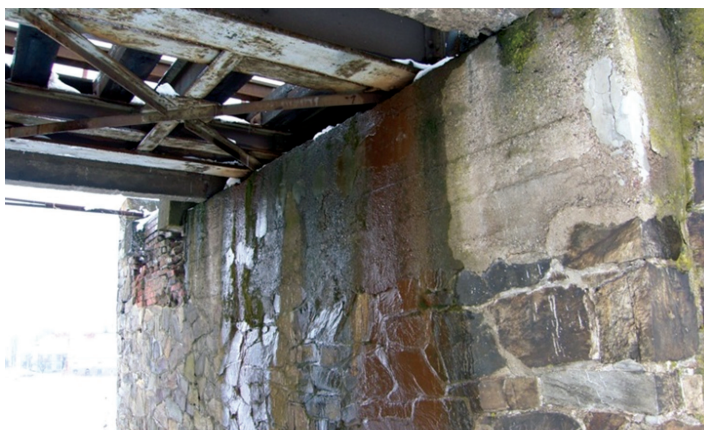
Fot. 8. Zawilgocone ściany przyczółków
