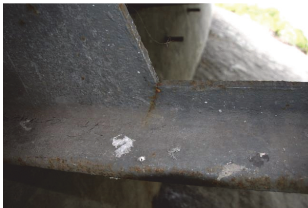
Rys. 3. Pęknięcie dźwigara stalowego w narożu otworu
