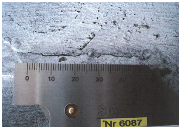
Rys. 4. Pęknięcie spiny dźwigara stwierdzone w 2013 r.
