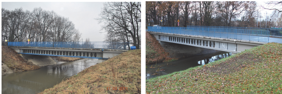
Rys. 2. Most drogowy przed i po zaspawaniu skrajnych otworów w środkach belek
