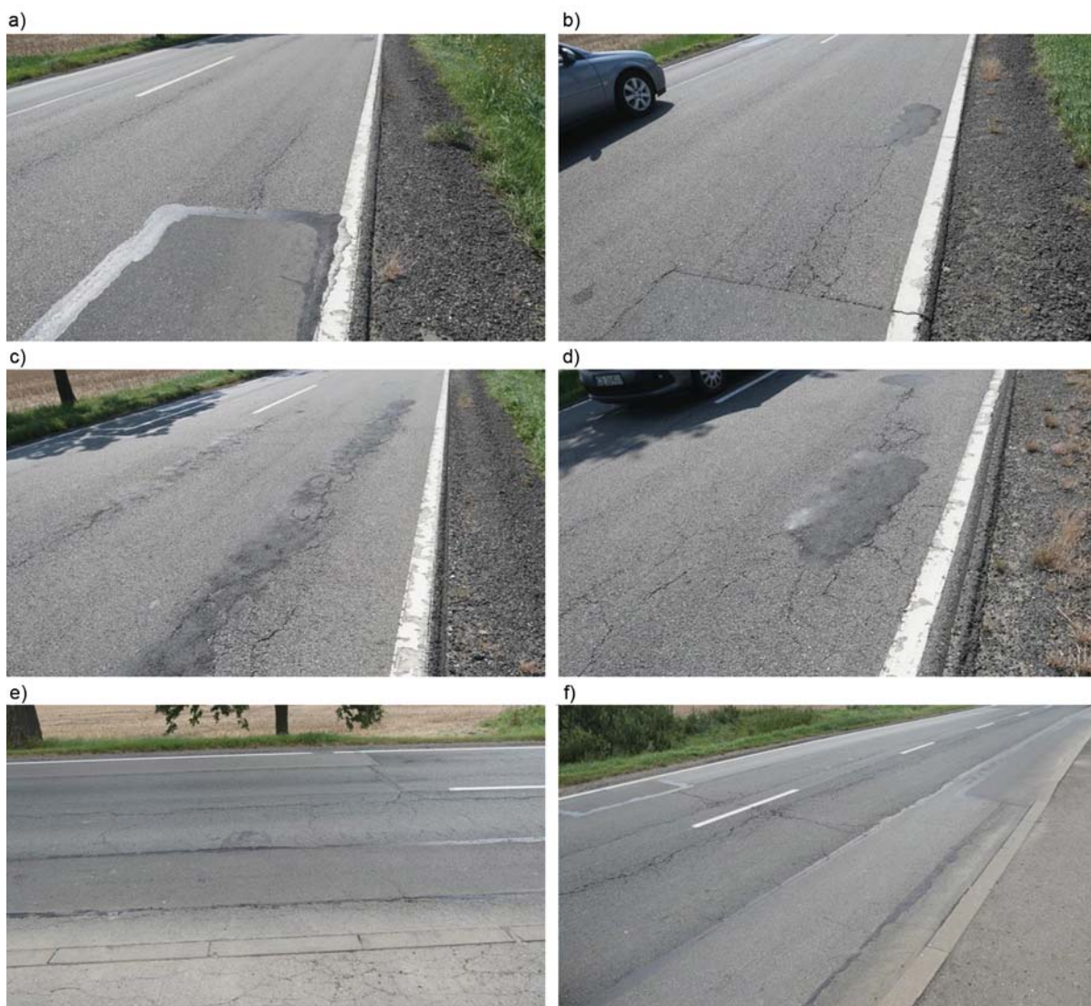
Rys. 2. Przykłady uszkodzeń nawierzchni drogi krajowej nr 55 od km 16+900 do km 17+600
