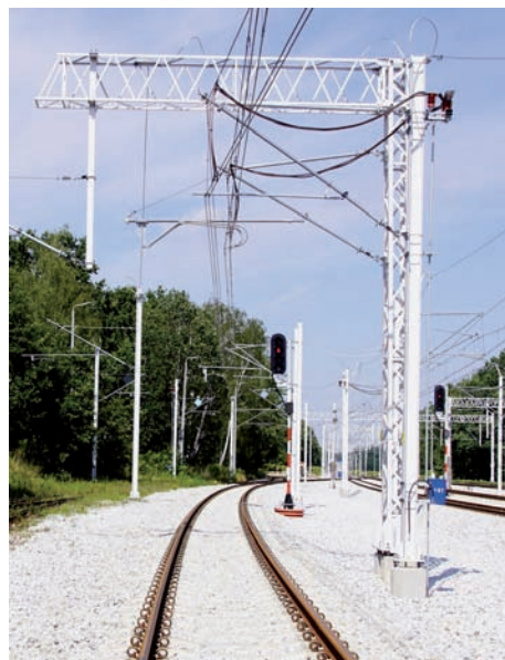
Rys. 1. Izolowane sześciostupowe przęsło naprężenia z odłącznikiem; Sieć YC120-2CS150, Łódź Żabieniec, 2021 [fot. D. Dratwa]
