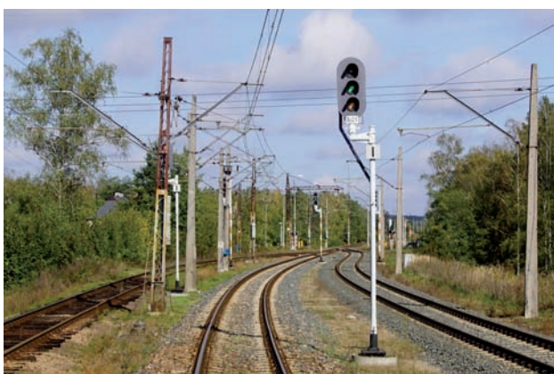
Rys. 14. Izolowane prześło naprężenia odłącznika nr 3 w łuku w Chociszewie przed przebudową stacji, 2019 [fot. D. Dratwa]
