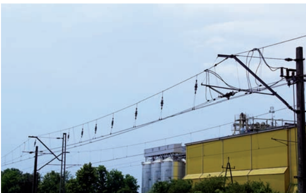
Rys. 8. Przerwa powietrzna z izolacją linii nośnej przy jednym z podwieszeń (tu z prawej) i wieszakami izolowanymi. W przewodach jezdnych zachowane są izolatory dzielcze ceramiczne z czasu elektryfikacji; wieszaki izolowane ceramicznymi izolatorami odciążu dwukłozowymi. Sieć YC120-2C, brak lin uelastyczniających Y przy podwieszeniach przerwy, Żerków, 2018 [fot. D. Dratwa]
