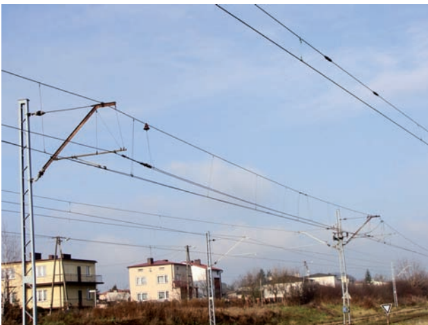
Rys. 7. Przerwa powietrzna z izolacją linii nośnej w środku przelotu; sieć C120-2C, Głowno, 2010 [fot. D. Dratwa]
