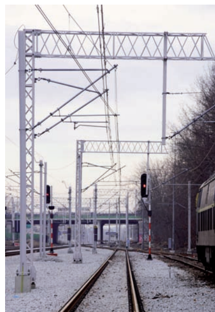
Rys. 2. Izolowane sześciostupowe przęsło naprężenia bez odłącznika/rozłącznika; sieć YC120-2CS150, Łódź Żabieniec, 2021 [fot. D. Dratwa]
