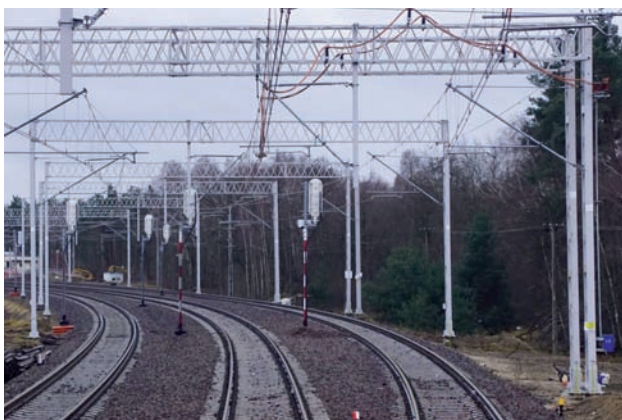
Rys. 15. Izolator sekcyjny przy rozłączniku nr 17 w miejscu izolowanego prześła naprężenia odłącznika nr 3, przy izolacji kotwieniu środkowym, Chociszew 2021 [fot. D. Dratwa]
