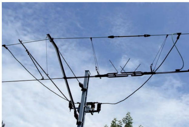
Rys. 3. Podwieszenie z izolatorem sekcyjnym z tworzyw sztucznych i odłącznikiem; sieć sKB70-C, Głowno, 2011 [fot. D. Dratwa]
