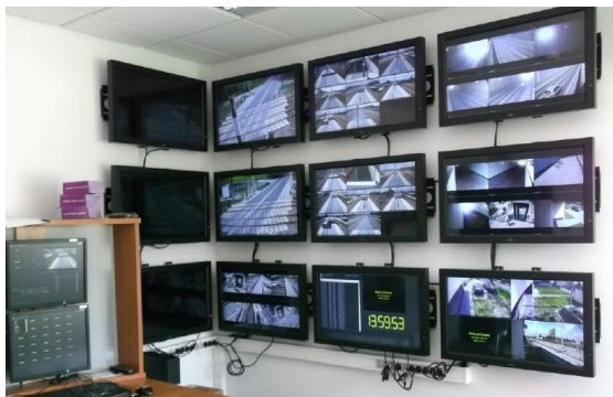
Fot. 7. Stanowisko Centrum Utrzymania i Diagnostyki na stacji Łuków
