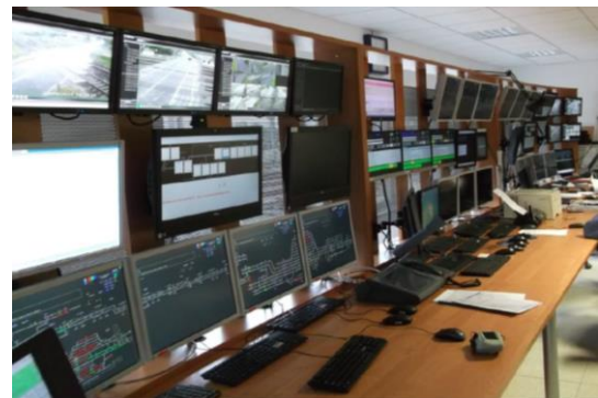
Fot. 6. Trzy niezależne stanowiska sterowania ruchem kolejowym w urządzeniach na stacji Łuków po przebudowie w 2017 roku
