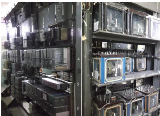
Fot. 4. Stojaki przekąźnikowych urządzeń sterowania ruchem kolejowym na stacji Łuków
