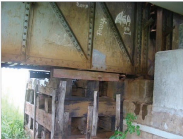
Rys. 2. Widoczna przerwa pomiędzy dźwigarem a dodatkowym podparciem [fot. R. Chmielewski]
