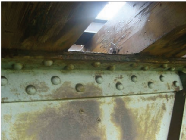
Rys. 6. Przykład korozyjnego uszkodzenia pasa górnego dźwigara [fot. R. Chmielewski]
