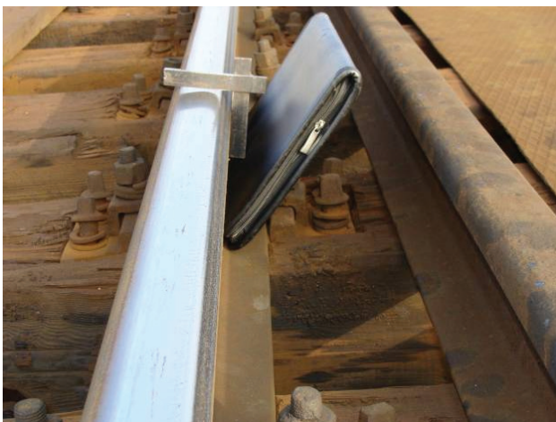
Rys. 9. Zużycie boczne główki szyny na początku drugiego przęsła od strony stacji Otok [fot. R. Chmielewski]
