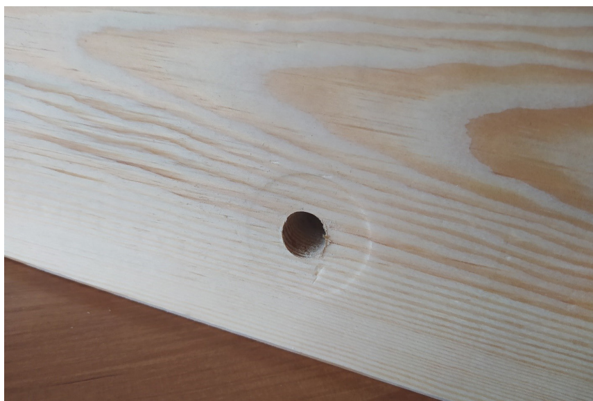
Fot. 4. Uszkodzenie belki głównej w obrębie podkładki; źródło: opracowanie własne
