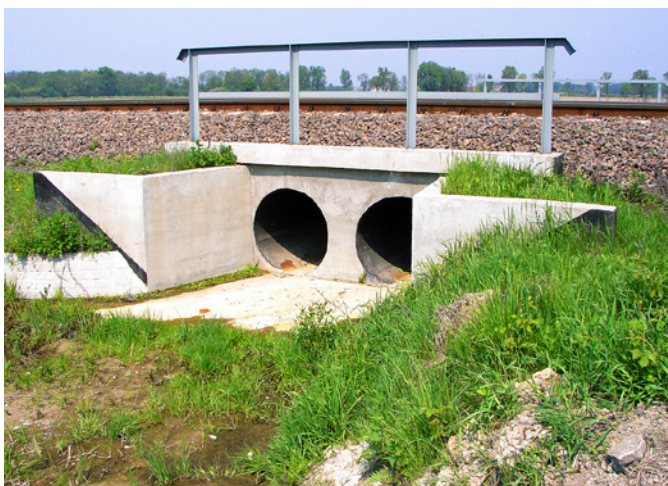
Ryc. 5. Przykład dwuotworowego przepustu o przekroju kołowym pod magistralną linią kolejową, fot. Z. Kubiak
