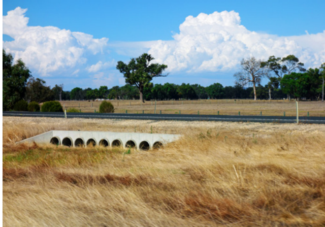
Ryc. 7. Przykład zastosowania przepustu 10-otworowego o długości całkowitej wynoszącej ok. 20,0 m pod autostradą (wzdłuż Oceanu Indyjskiego) na terenie nizinnym w Australii Zachodniej, fot. A. Wysokowski
