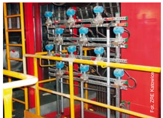
Fot. 4 Stojak aparatury AKPiA do pomiaru ciśnień
