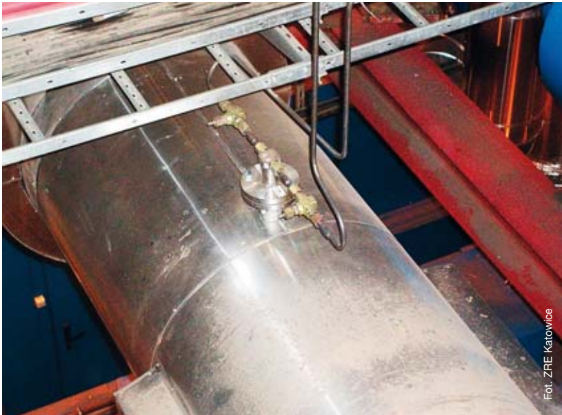
Fot. 3 Pomiar przepływu powietrza rurką spiętrzącą TWIN-BAR
