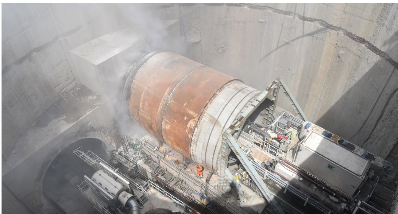
Rys. 4. TBM Faustyna drążąca tunel między Łódź Fabryczna a Łódź Kaliska; źródło: http://tunnel-laczypolske.pl/ [dostęp: 18.08.2022]
