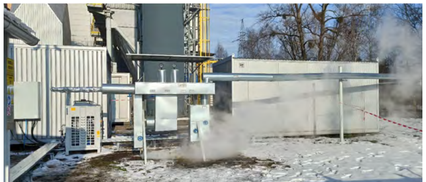
Rys. 6. Stacja rozprężania pary w trakcie pracy. Doprowadzenie pary technologicznej z bloku biomasowego do instalacji rSOC Źródło: CTH 2 IEn
