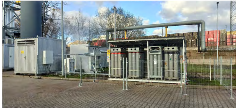
Rys. 4. Zdjęcie Instalacji rSOC w trakcie realizacji prac badawczych Źródło: CTH 2 IEn
