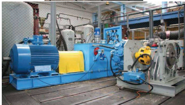
Rys.11. Stanowiska do badań napędów elektrycznych i elementów hydrauliki górniczej [13]
