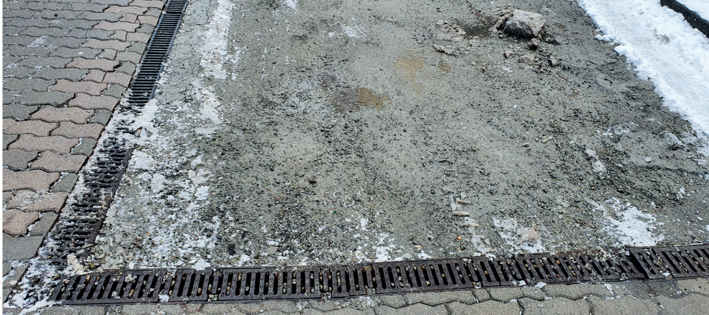
Przemrożona górna warstwa nawierzchni betonowej
