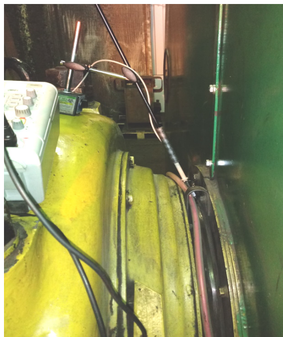
Rys. 5. Pomiar napięcia wałowego oraz prądu łożyskowego przy łożysku Ł2
