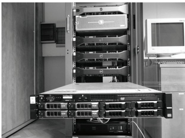
Rys.1. Stanowisko do wirtualnego prototypowania (specjalistyczny serwer obliczeniowy), zamontowane w szafie serwerowej [1]
