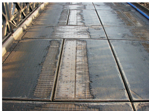
Rys. 4.3. Uszkodzenia nawierzchni jezdni z płyt ortotropowych [3]
