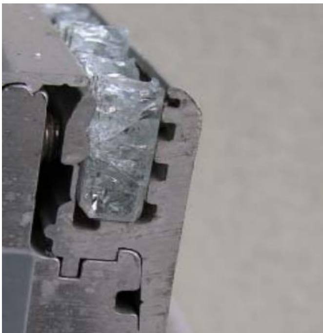
Rys. 7. Brak elastycznych przekładek kompensujących wpływ temperatury na długość tafli oraz zabezpieczających przed lokalnym dociskiem elementów okucia
