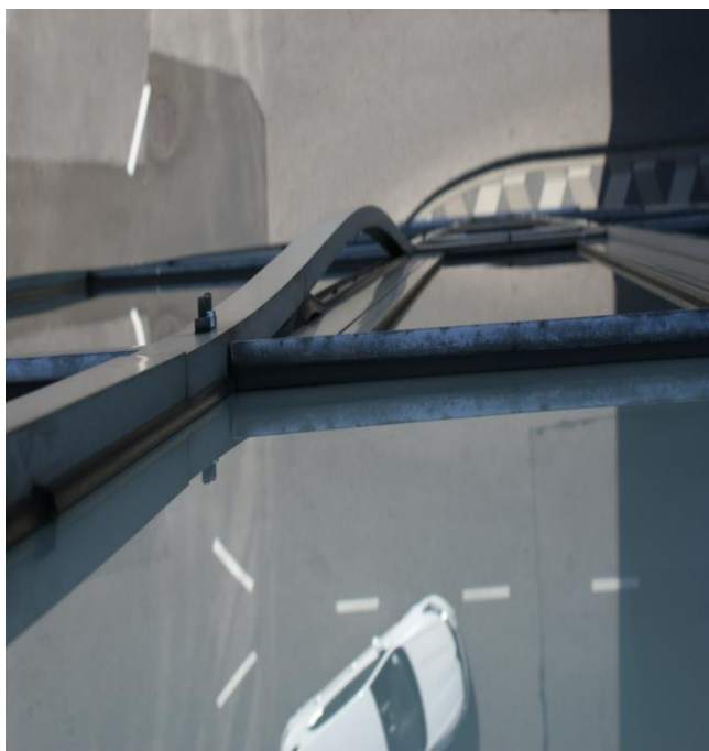
Rys. 4. Spaczony element maskownicy, widoczne dodatkowe, nieujęte w projekcie mocowanie za pomocą śrub, które ograniczało możliwość odkształceń termicznych
