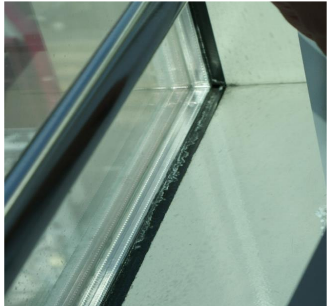
Rys. 8. Sparciała wykruszająca się uszczelka, zacieki świadczą o przenikaniu do środka wody
