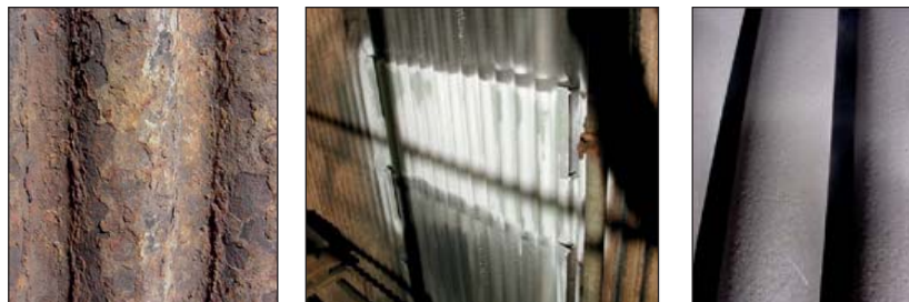
Rys. 2. Powierzchnia ekranu ze śladami korozji oraz powierzchnia zabezpieczona natryskiem (bezpośrednio po wykonaniu i po 1-rocznym okresie pracy)
