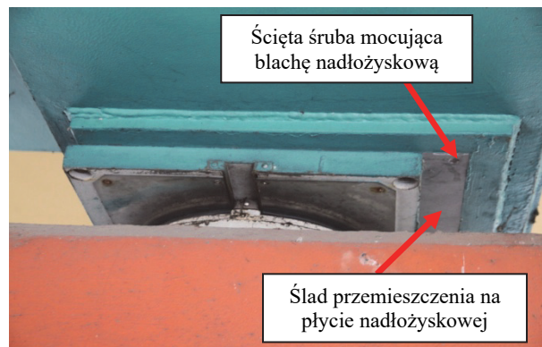
Fot. 9 Przesunięcie poziome elementów łożyska wielokierunkowo przesuwne na podporze 7 – przesunięcie prostopadłe do osi mostu – ok. 56mm
