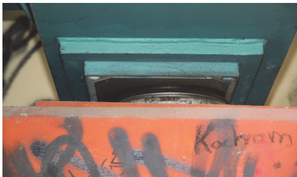
Fot. 2. Przemieszczenie poziome elementów łożyska wielokierunkowo przesuwne na podporze 1 (na przyczółku) – zbliżenie z fot. 1
