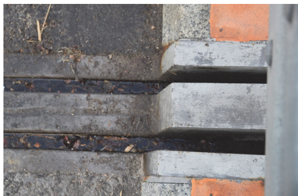
Fot. 6 Przesunięcie poprzeczne urządzenia dylatacyjnego (krawędzi jezdni) jako skutek przemieszczenia przyczółka (podpory nr 1)
