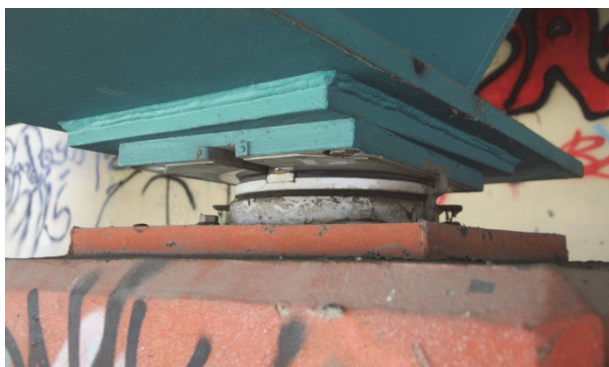
Fot. 3 Przemieszczenie poziome elementów łożyska jednokierunkowo przesuwne na podporze 1 (na przyczółku). Widoczne skrócenie blachy nadłożyskowej względem blachy klinowej spawanej do pasa dźwigara
