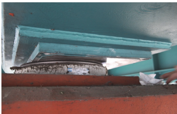
Fot. 7 Przesunięcie poziome elementów łożyska względem dźwigara na podporze 7
