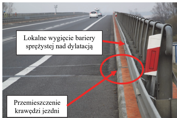
Fot. 5 Przesunięcie krawężnika (krawędzi jezdni) jako skutek przemieszczenia przyczółka (podpory nr 1)
