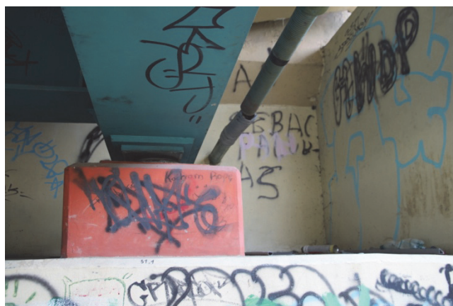
Fot. 1. Przemieszczenie poziome elementów łożyska wielokierunkowo przesuwne na podporze 1 (na przycółku)
