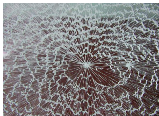
Rys. 2. Tafla szkła bezpiecznego po pęknięciu [5]
