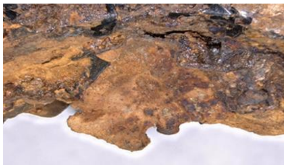
Rys. 8. Osad korozyjny wewnątrz rury stalowej (fot. A. Jaszczurowska). Fig. 8. Corrosive deposit inside the steel pipe (photo by A. Jaszczurowska).
