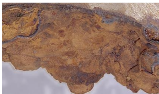
Rys. 7. Osad korozyjny wewnątrz rury żeliwnej (fot. A. Jaszczurowska).
