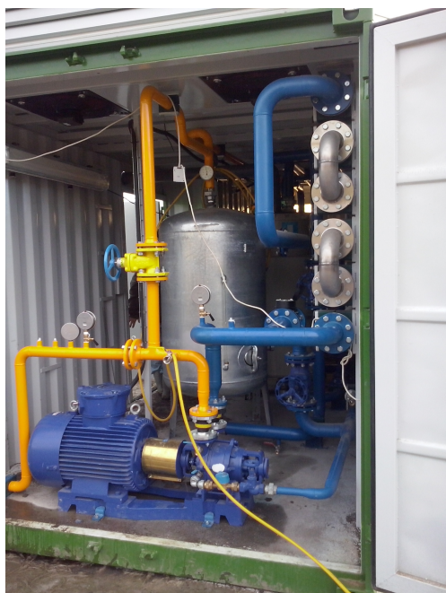
Rys. 1. Moduł I – urządzenia upgradingu biogazu
