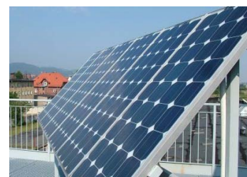
Ryc. 3. Bielawa – Szkoła Słoneczna (Centrum OZE). Widok dachu i instalacji PV. Źródło: [1]
