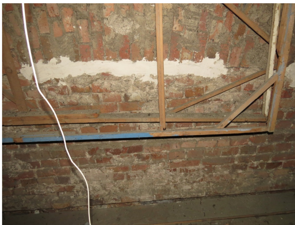
Rys. 8. Nienaruszone plomby gipsowe w miejscu pęknięcia (Autor, 2016)
