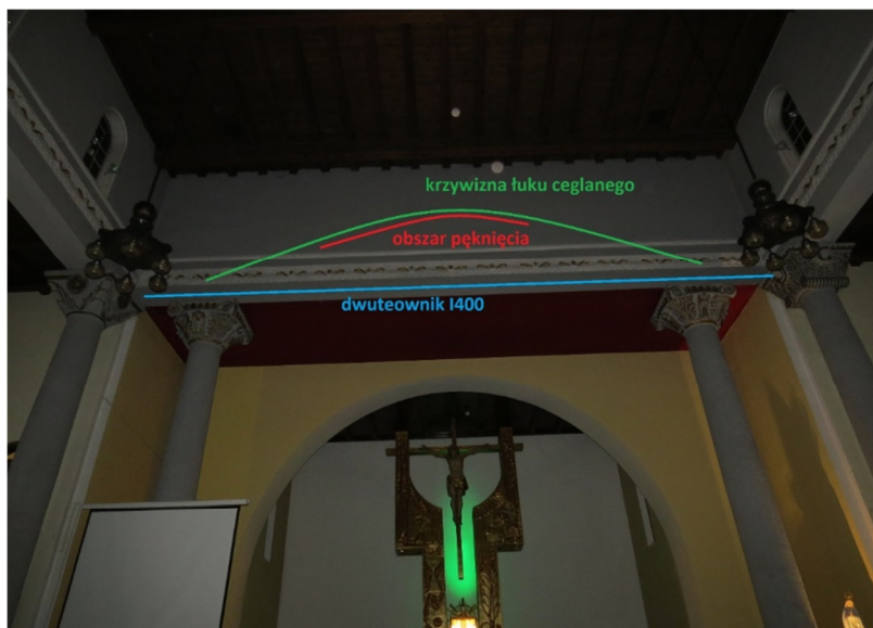
Rys. 5. Miejsce pęknięcia – widok z wnętrza kościoła (Autor, 2016)
