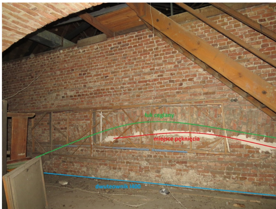
Rys. 7. Miejsce pęknięcia i plomby gipsowe - widok z poziomu poddasza (Autor, 2016)
