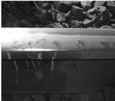
Rys. 16. Głębokie nadpęknięcia w szynach
