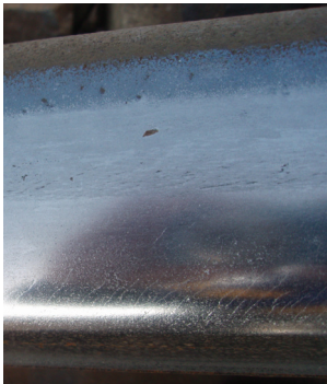
Rys. 3. Nadpęknięcia krawędziowe szyny
