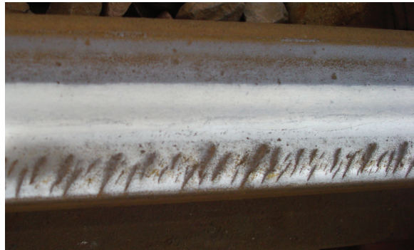
Rys. 4. Nadpęknięcia krawędziowe szyny
