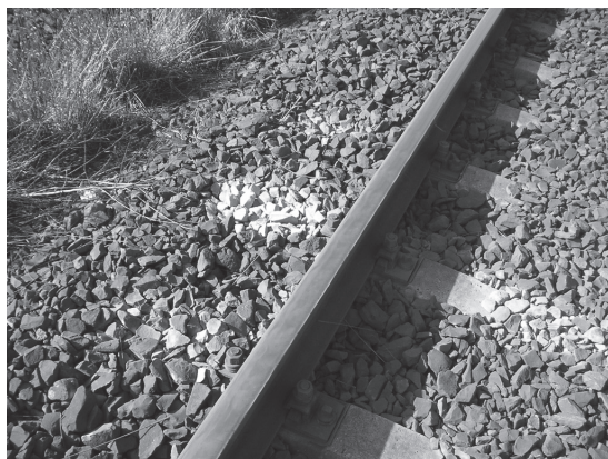
Rys. 5. Duże wady nadpęknięć krawędziowych w obszarze wychłapek
