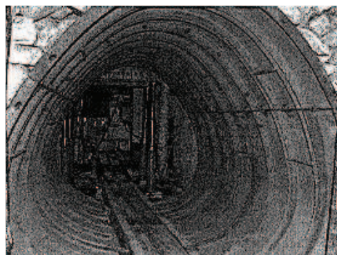
Rys. 4. Obudowa tubingowa zabudowana w chodniku [8]
