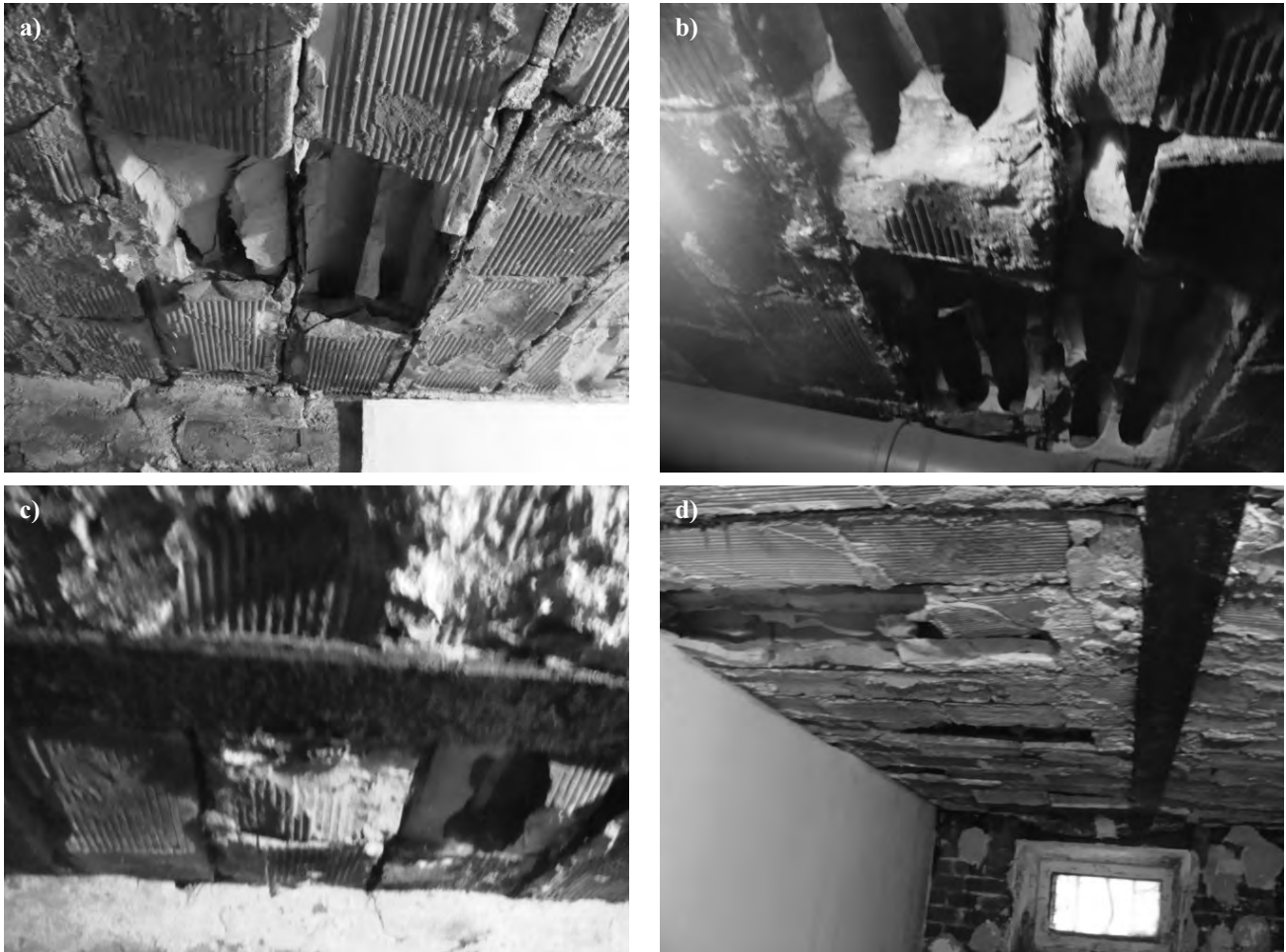
Rysunek 2.3. a ÷ d) Widoczne uszkodzenia zbrojonej płyty ceglanej stropu Klein'a
