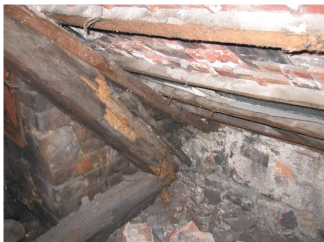
Rys. 7. Zawilgocona ścianka kolankowa; końcówki krokwi skorodowane, brak przypustnic, ugięte łąty pod dachówką
