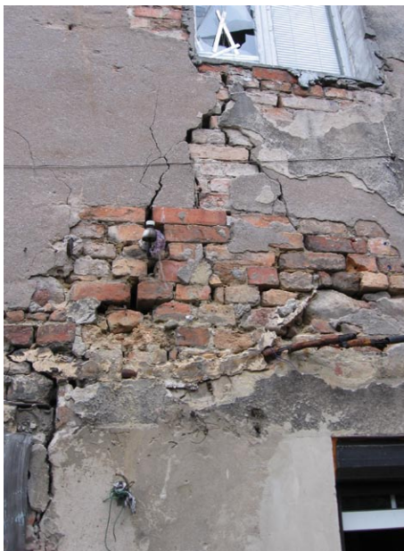
Rys. 3. Fragment elewacji południowej; ukośna strukturalna rysa, rozluźniony wątek, ubytki w spoinie
