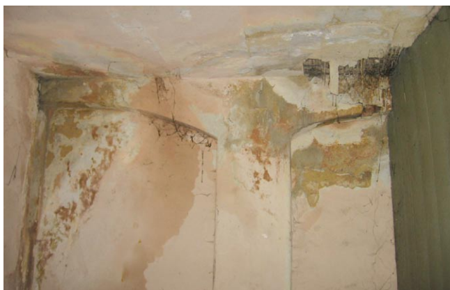
Rys. 4. Fragment ściany wschodniej na piętrze; silne zawilgocenie ściany i stropu z powodu nieuszczelnności kosza
