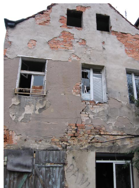
Rys. 2. Elewacja południowa; liczne pęknięcia i ubytki w konstrukcji muru
