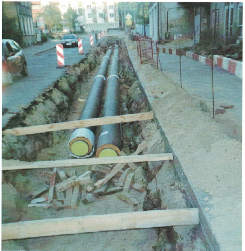
Fot. 1. Przykładowa sieć preizolowana
