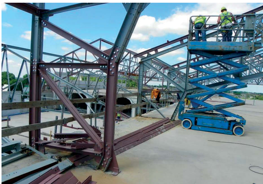
Rys. 2. Podniesienie konstrukcji o 2,5 m przez dodanie modułu kratowego, z zachowaniem kształtu historycznego układu nośnego [3]
