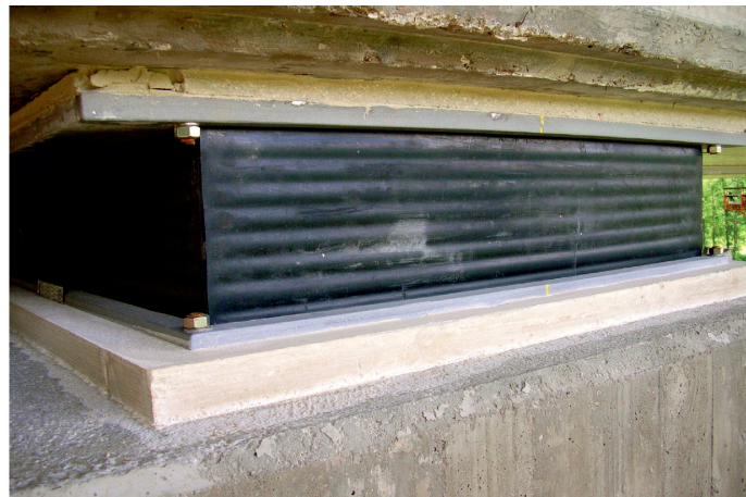
Fot. 7. Łożysko elastomerowe dużej nośności (ponad 10 MN) po wbudowaniu (ze zbioru autora)
