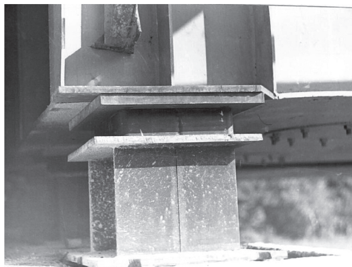
Fot. 4. Pierwsze polskie łożyska elastomerowe nośności 1,2 MN wbudowane zamiennie zamiast łożysk wałkowych w moście na CMK [14]
