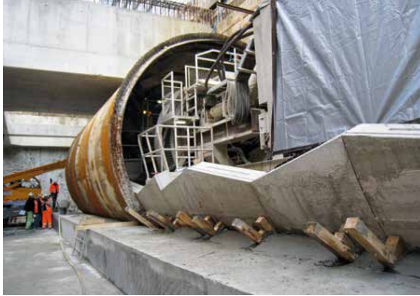
Dlatego między innymi terminowe wykonanie stacji „Centrum Nauki Kopernik”, roboczo nazywanej wówczas „Powiśle”, której fragment znajduje się pod tunelem Wistostrady, był kluczowym elementem harmonogramu prac. Awaria, która wydarzyła
