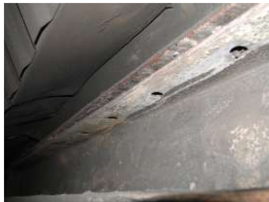
Rys. 4. Uszkodzone, poluzowane i zniszczone połączenia śrubowe łączące obudowę mechanizmów przenośnika z konstrukcją filtru w obszarze segmentów 1, 2 [1].
