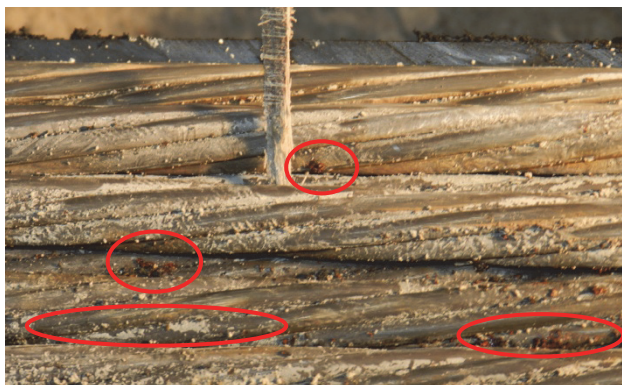
Rys. 9. Ogniska korozji w miejscach usuniętej osłony i iniektu
