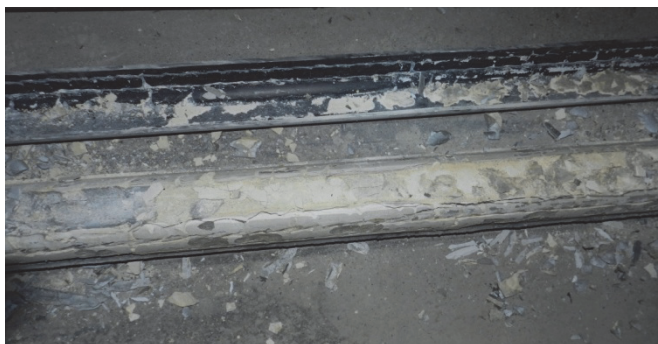
Rys. 7. Wygląd iniektu uszkodzonego kabla. Iniekt o odcieniu żółtym w górnej części kabla, o małej wytrzymałości i niezwartej strukturze
