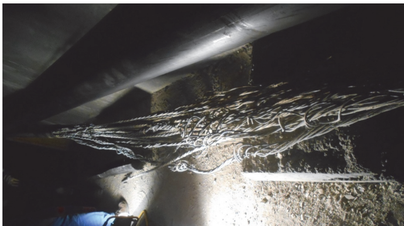
Rys. 2. Widok kabla w miejscu zerwania po usunięciu osłony poliuretanowej – pierwsza odkrywka liczona od podpory 5 (oznaczenia „A” rys. 3)
