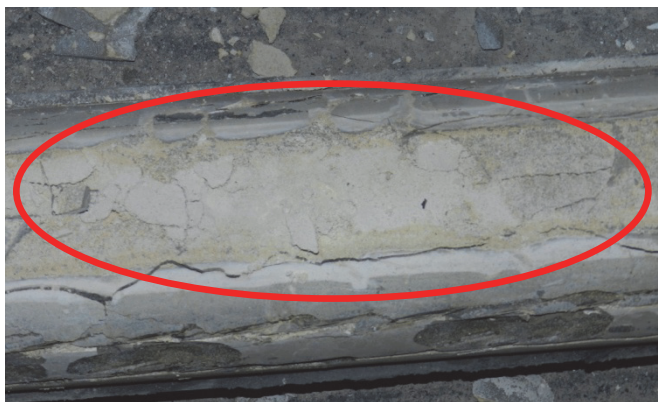
Rys. 8. Wygląd iniektu uszkodzonego kabla. Zaznaczony elipsą obszar – iniekt o odcieniu żółtym, o małej wytrzymałości i niezwartej strukturze
