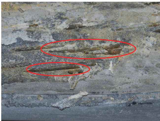
Rys. 10. Ogniska korozji splotów – widoczne po usunięciu iniektu
