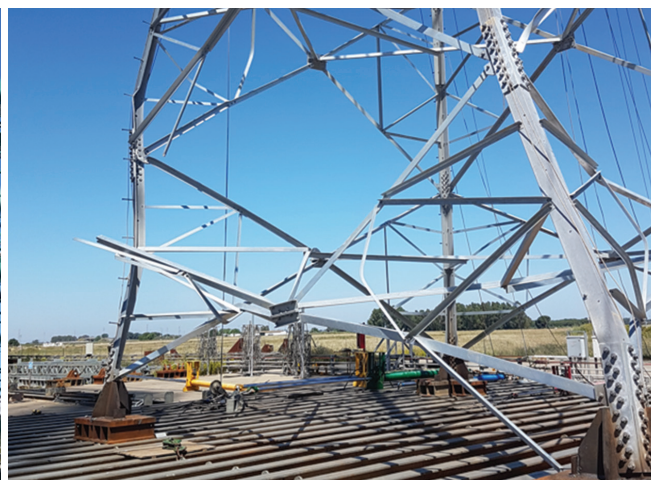
Fot. 2. Utrata nośności połączeń rozciąganych dolnej sekcji słupa EN422:10
