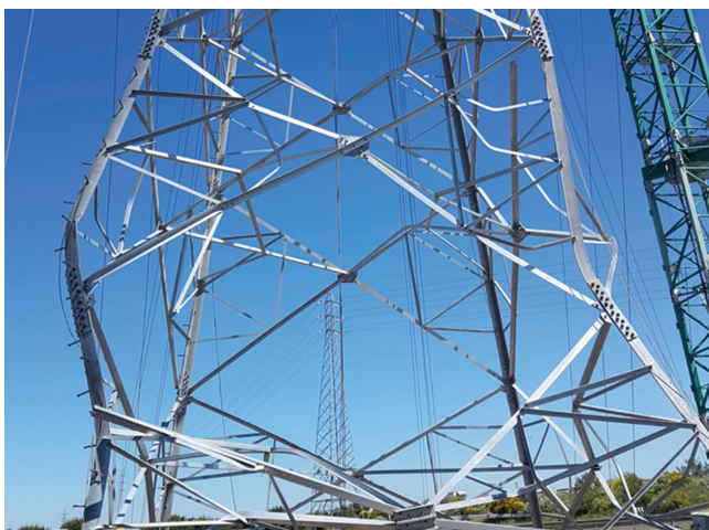
Fot. 1. Postać zniszczenia dla kombinacji obciążeń ze skreśnieniem trzonu słupa EN422:10
