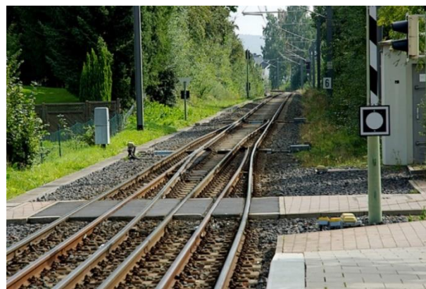
Rys. 4. Podwójne sploty torowe w rejonie peronów przystankowych na jednotorowej linii Kassel Hbf - Hessisch Lichtenau w Kassel [8]
